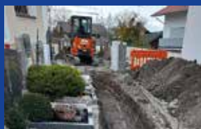
Fernwärme Markus Walgenbach Seite 21
